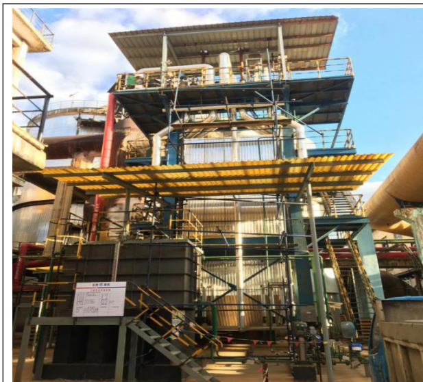
三系列热管锅炉概貌
